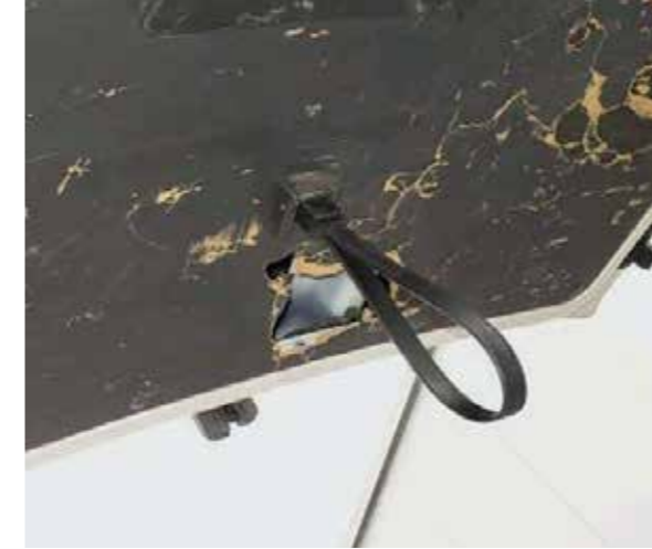
Innenverkleidung stark beschädigt
