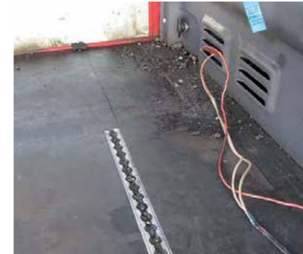
Unsachgemäßer Kabelverbau durch den Kunden
